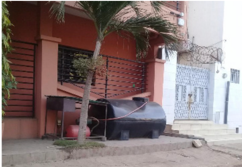
Photo 2 - Réservoir de stockage équipé de supprimeur, Hann Diamniadio (Mendy, enquêtes de terrain) Maristes 1
